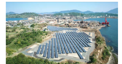
彦島製錬 太陽光発電所
